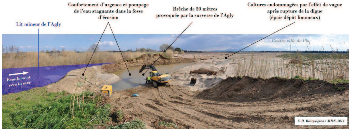
Figure 71. Rupture de la digue de l'Agly, à Pia
