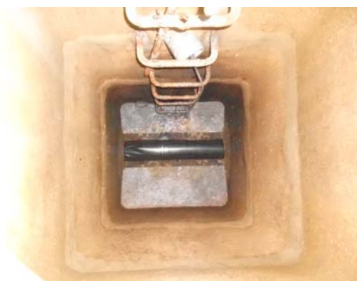
Regard de visite – réseau d'assainissement
