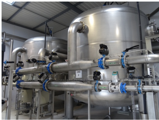
Filtre à charbon (Usine de Saints)
