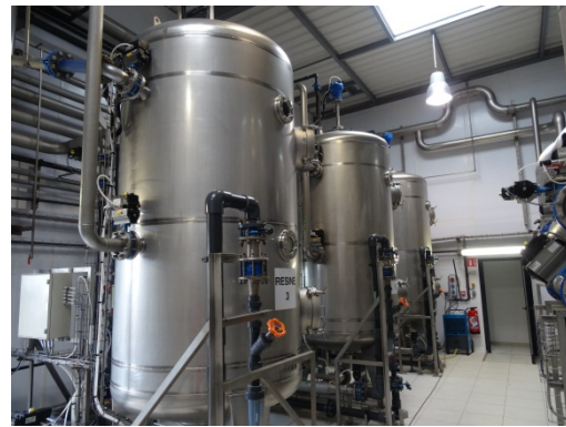
Résine échangeuse d'ions (Usine de Saints)
